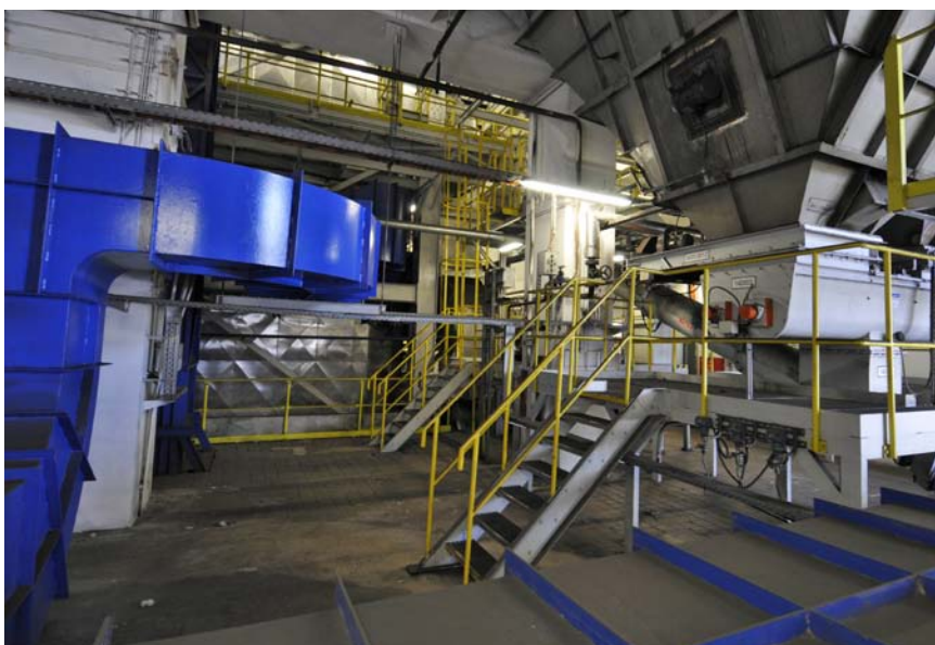
► Provozní zásobník uhlí fluidního kotle
