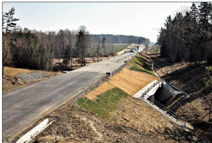
Pohled zpět jižním směrem na most přes Habří potok, který má délku 30 m a jehož dvě klenutá pole šikmo podchází trať. Prostorové dimenzování bylo dáno potřebou průchodu zvěře pod trať v biokoridoru potoka. V dále na horizontu je tunelový most popsán na sousedním snímku.
