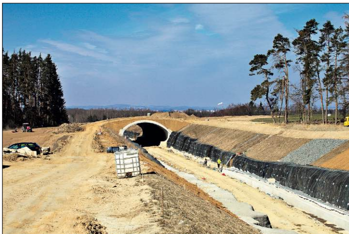
Trať vedoucí dlouhým zářezem je zhruba po 1,5 km od místa na předchozím snímku překlenuta tunelovým mostem, jenž má u vrcholu klenby délku 60 m. Ten přes trať převádí jednak polní cestu a jednak biokoridor, vedený mezi výběžky lesa, patrnými na snímku.
