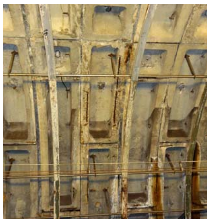
▲ Na nástupišti byl po demontáži prvků opláštění stanice zjištěn nevyhovující stav železobetonových dílců ostění staničních tunelů (tubingů). Projekt předpokládal přetěsnění tubingů, ale ty mají na několika místech oprýskanou krycí vrstvu betonářské výztuže, což bylo nutné před těsněním opravit (sanovat) a teprve poté provést přetěsnění spár mezi jednotlivými dílci.
