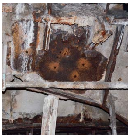
▲ Po demontáži prvků opláštění stanice (smaltovaných plechů a zontů) byl zjištěn nevyhovující stav ocelových průvlaků nesoucích železobetonové dílce ostění staničních tunelů. Podrobný průzkum a laboratorní zkoušky zjistily zvýšený výskyt chloridů na povrchu oceli. Pro zamezení přístupu chloridů ke konstrukci je navržena cementová injektáž prostoru za železobetonovými dílci ostění staničních tunelů (tubinky), která byla doplněna injektáží z polyuretanu. Na některých místech je oprýskán protipožární nástřik ocelových konstrukcí (dle PBŘ má vykazovat odolnost 180 min. v tl. 50 mm), ve skutečnosti naměřeno 6–8 mm. Některé části ocelových průvlaků nejsou zastříkány protipožárním nástřikem vůbec a z části ocelových prvků se protipožární nástřik loupe v plátech. Ocelové prvky bez nástřiku torkretu vykazují známky koroze.
