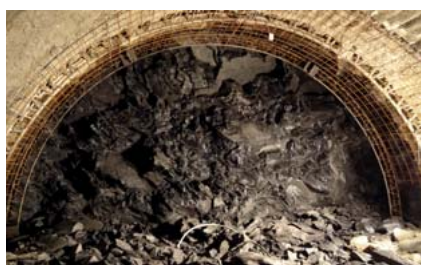
▲ Při ražbě přestupní chodby bylo pro zrychlení ražeb přikročeno k použití trhacích prací malého rozsahu, čelba po odstřelu a osazení příhradových rámu s KARI sítí před zastříkáním stříkaným betonem
