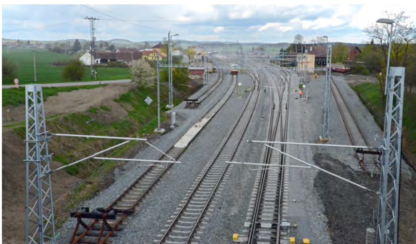
► pohled na budějovické zhlaví směrem do stanice, vpravo je objekt bývalého depa dnes vlečky Výtopna Babin
