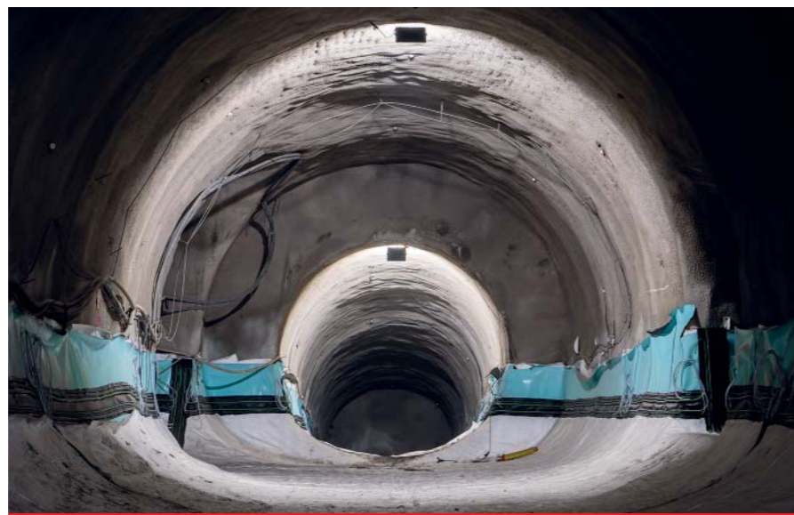
Ražba traťového tunelu Pankrác - Olbrachtova, strojovna vzduchotechniky
