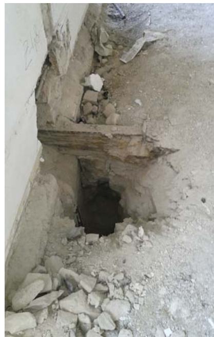
◀◀ Trhlina v objektu SO 09 Vliv porušení původních táhel
